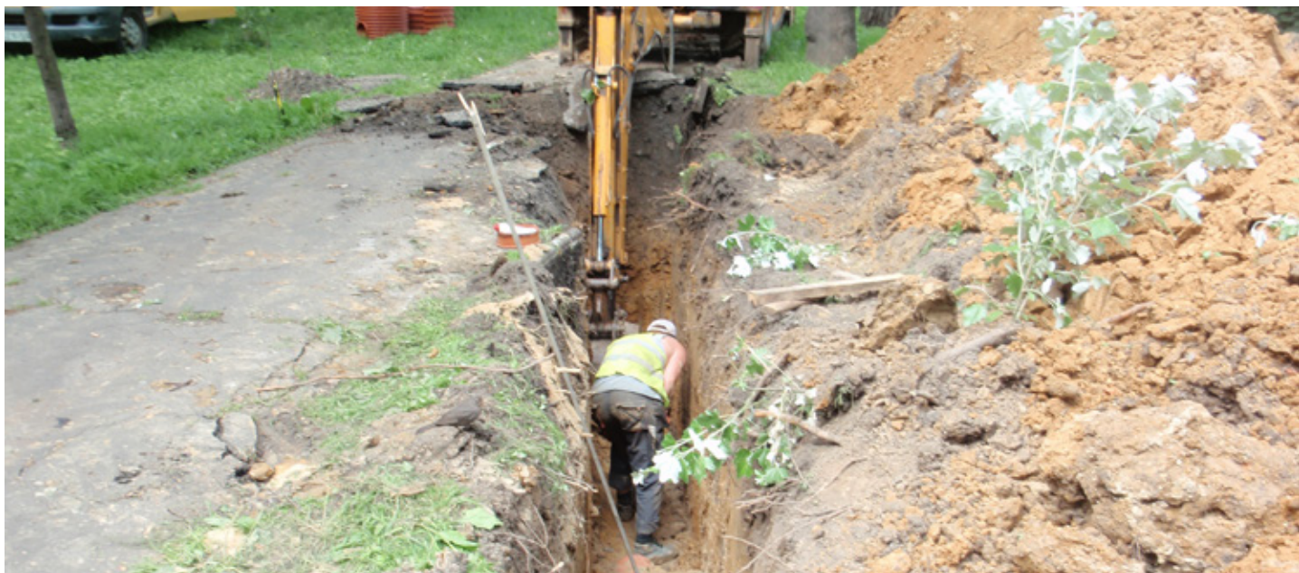
Fot. 20. Wykonywanie prac w Strefie Ochronnej Drzewa (SOD) metodą otwartego wykopu powoduje uszkodzenie korzeni
