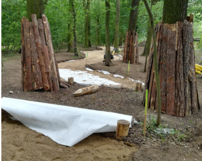
Fot. 23. Budowa żwirowego ciągu pieszo-rowerowego w Swojczyckim Parku Czarna Woda. Pomiędzy drzewami rosnącymi blisko siebie umiejscowiony będzie fragment chodnika rampowego (fot. Aleksandra Zienkiewicz)
